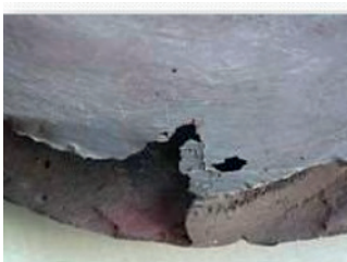
Corrosión por cavitación
